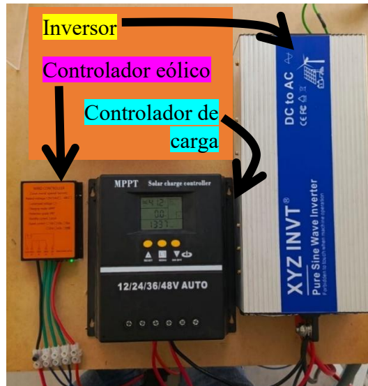
Figura 36. Banco para la regulación, inversión y almacenamiento de la energía eólica generada.
