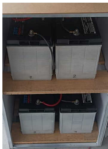
Figura 37. Banco de baterías establecido.
