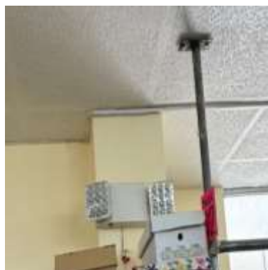
Lampara de emergencia ubicado en el segundo piso almacen en la parte superior
