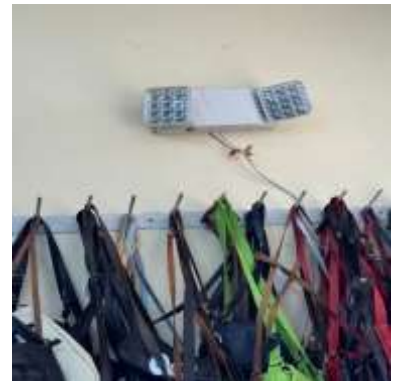
Lampara de emergencia ubicado en el interior del almacen.
