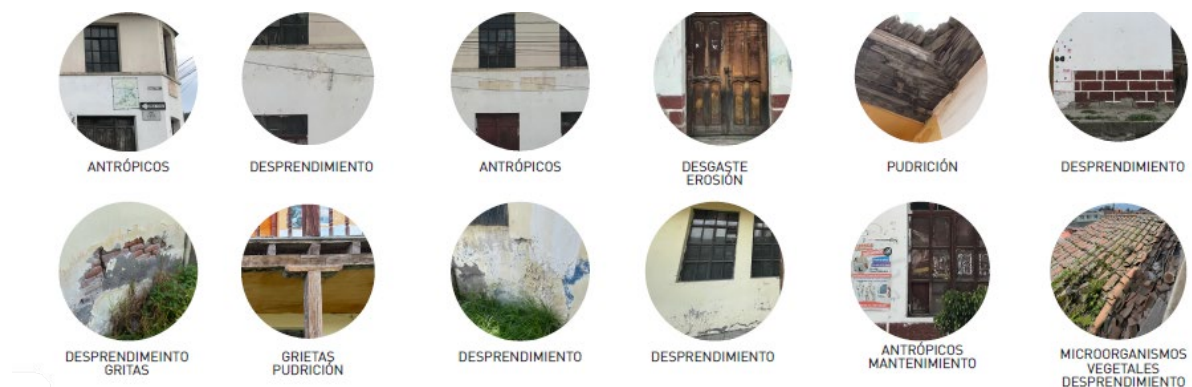
Figura 45. Recopilación de lesiones en fachadas y cubierta
