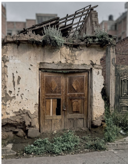
Figura 3. Deterioro de las viviendas en Yaruquies
