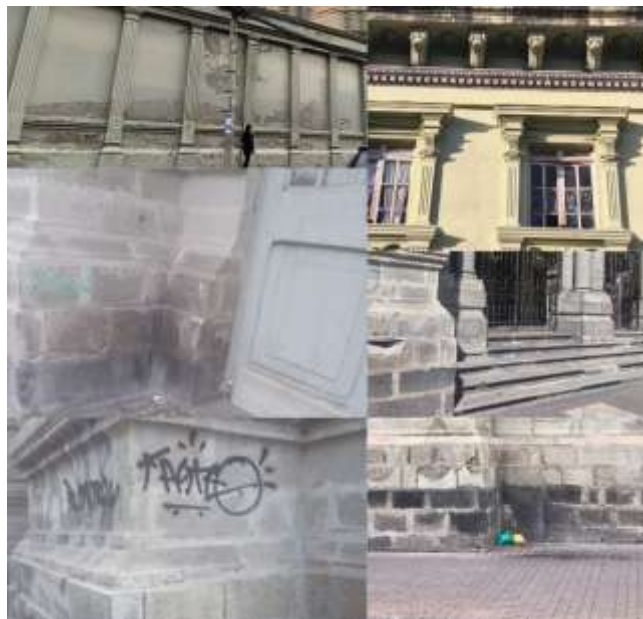
Figura 3. Fachadas de colegio Maldonado con daños provocados
