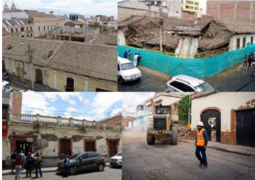
Figura 2. Galería de edificaciones destruidas en la ciudad de Riobamba
