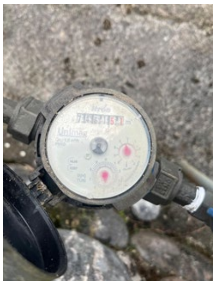
Figura 8. Medidor ITRON de chorro único instalado en vivienda residencial
