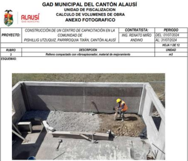
Figura 3. 13. Incumplimiento del rubro #3 de la Obra 16
