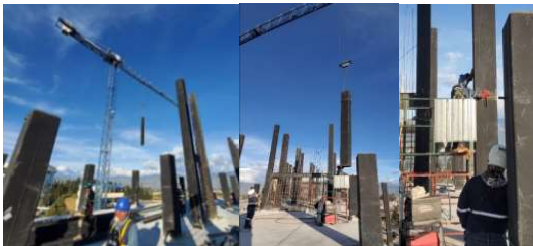
Anexo 12. Recolección de datos UNACH campus norte del montaje de acero estructural en columnas
