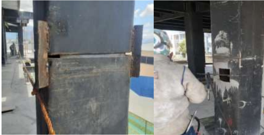
Anexo 13. Recolección de datos UNACH campus norte del montaje de acero estructural en columnas – juntas de soldadura
