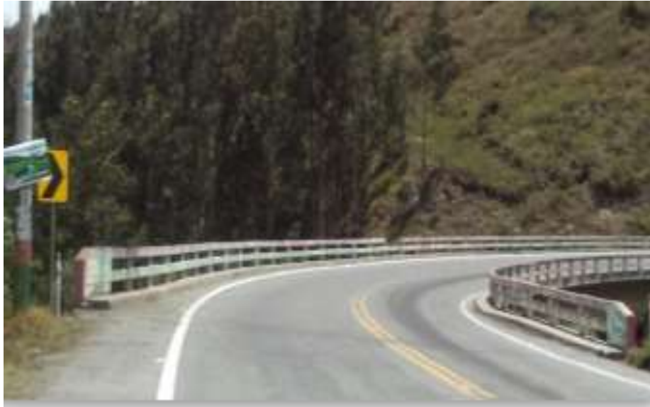
FOTOGRAFÍA 17: NO TIENE SEÑAL VERTICAL DE PESO MÁXIMO PERMITIDO DEL PUENTE.
