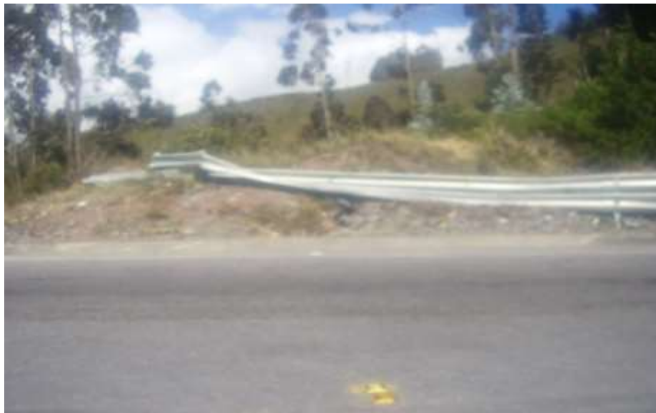
FOTOGRAFÍA 18: BARANDA EN MAL ESTADO.
