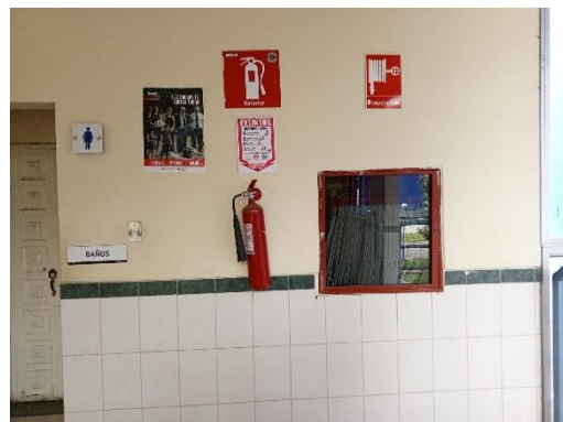
Figura 45. Gabinete de incendio
