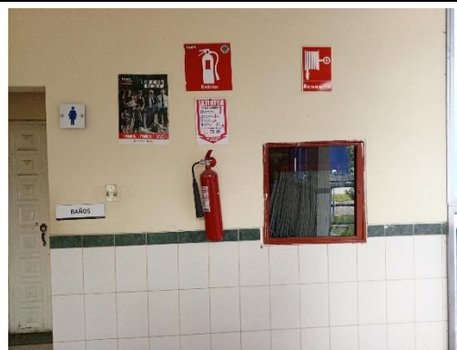
Figura 31. Equipo contra incendio
