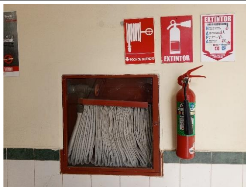
Figura 17. Gabinete de incendio
