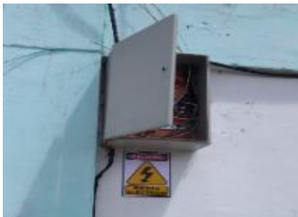
Figura 7: señalética de riesgo Eléctrico
