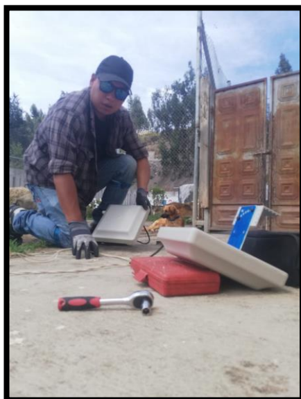
Figura 38: Instalación de lectores RFID
