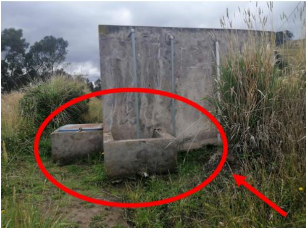
Anexo 14 Evidencia de patología en el punto 49
