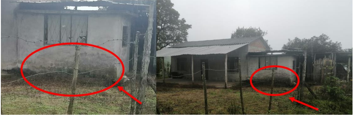
Anexo 2 Evidencia de patología en el punto 8
