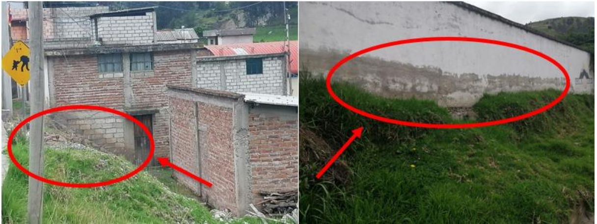
Anexo 5 Evidencia de patología en el punto 26
