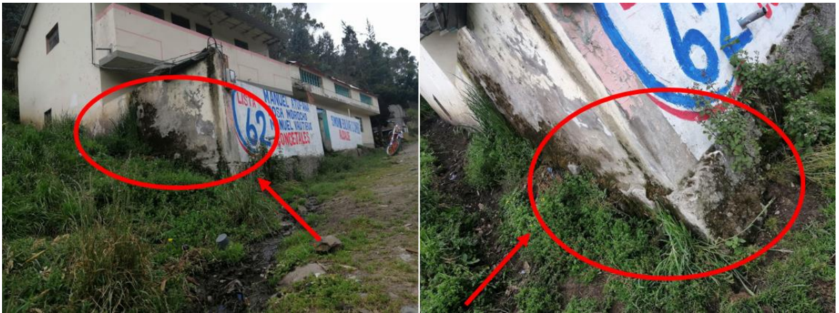
Anexo 8 Evidencia de patología en el punto 35
