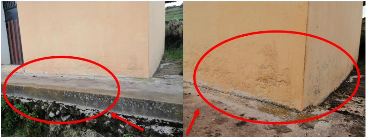
Anexo 11 Evidencia de patología en el punto 44
