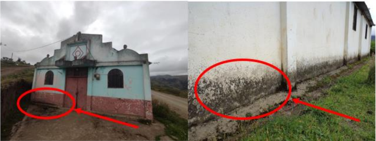
Anexo 17 Evidencia de patología en el punto 79
