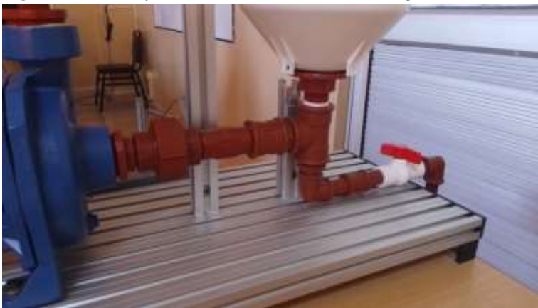
Figura 11 Parte inferior del sistema de bombeo de agua utilizando accesorios de tubería de ½ y 1 pulgada
