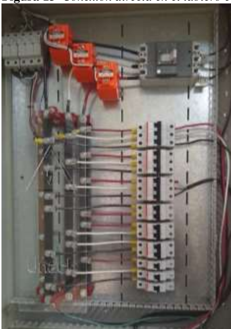
Figura 13 Conexión directa en el tablero eléctrico de 220 v
