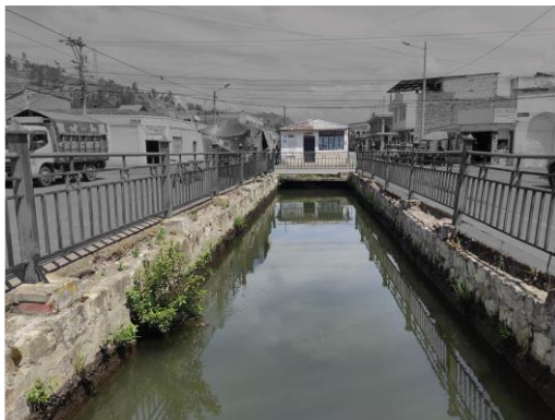
Ilustración 26: Deterioro del canal de riego, Fuente: Grupo de Trabajo, 2022
