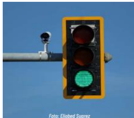
Figura 4 Dispositivo de Control. Semáforo.
