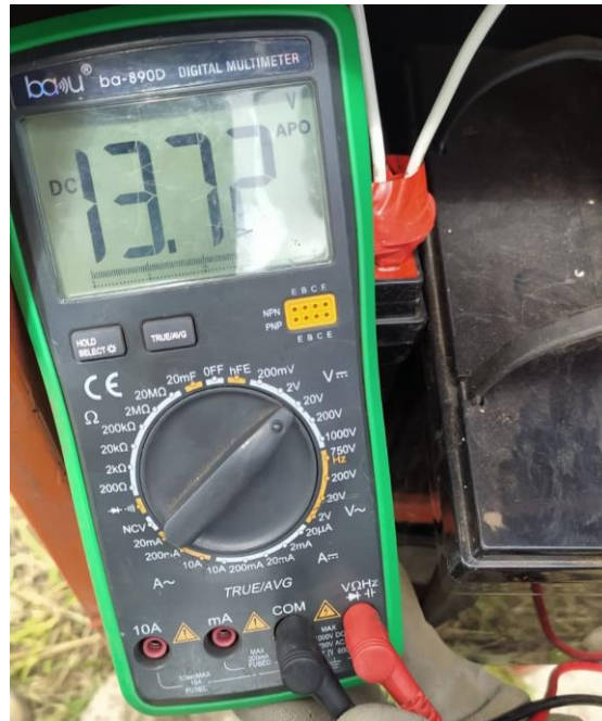
Figura 55. Nivel de voltaje entregado por el sistema de alimentación por baterías.
