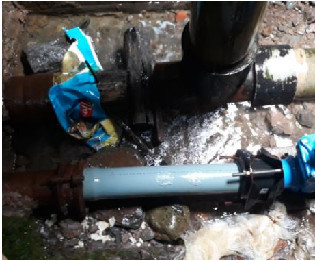
Medición de caudales inyectados Chambo - tanque Verde
