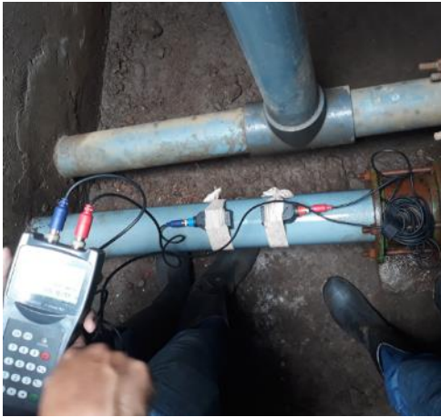
Medición de caudales inyectados Chambo - tanque Blanco
