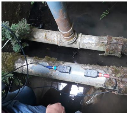
Medición de caudales inyectados Chambo - tanque Reserva
